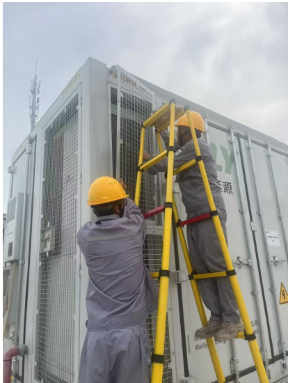
▲在义乌苏溪变独立储能电站内,运维人员趁着下午储能单元静置时段,对储能电源液冷机组开展检查与清理工作,以此保障迎峰度夏期间设备安全高效运行。
